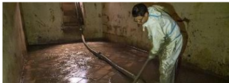
Rimozione del fango in una cantina alluvionata in una foto di inizio giugno
